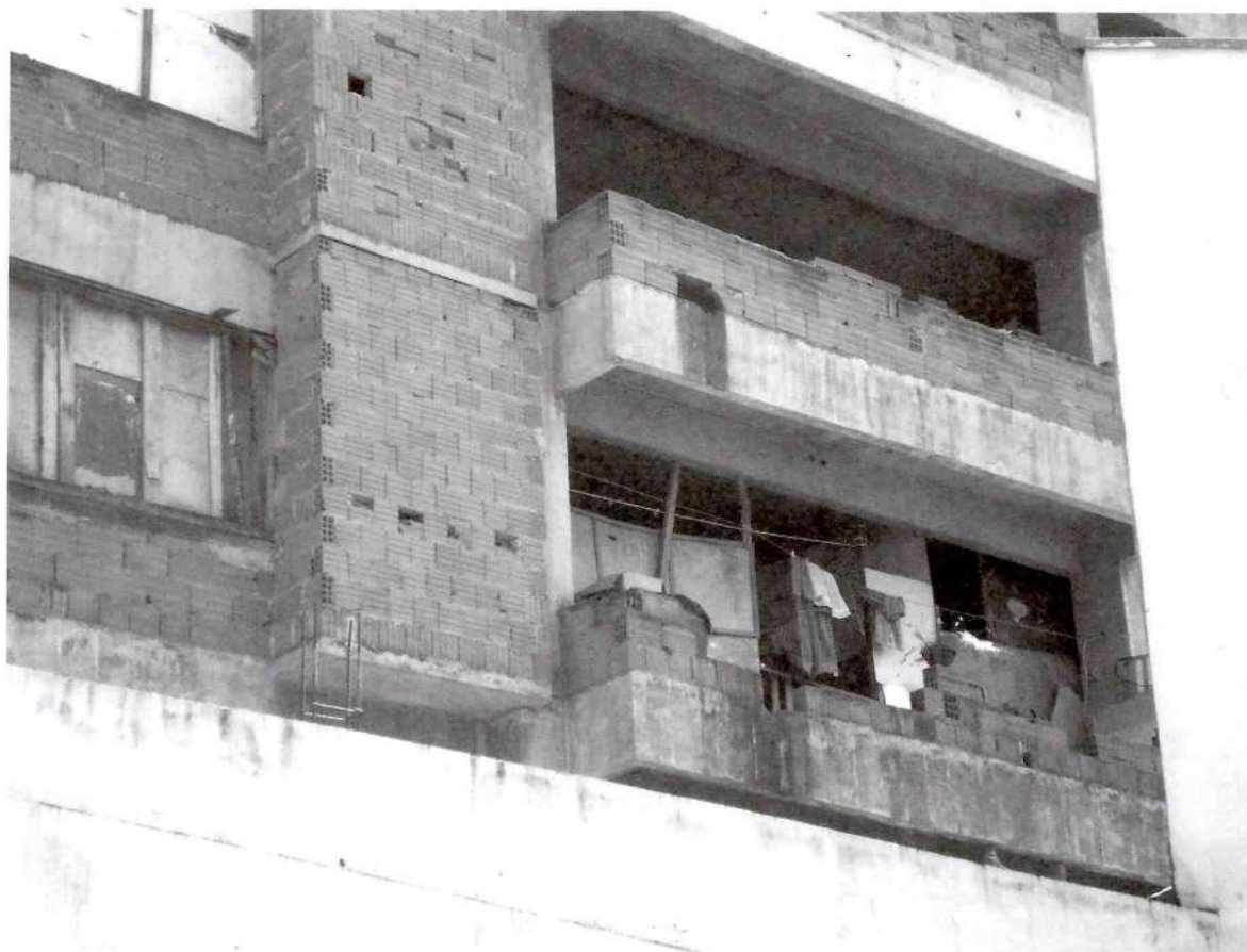
Figura 2 – Prédio inacabado invadido. Moradia de Maria Damiano.
