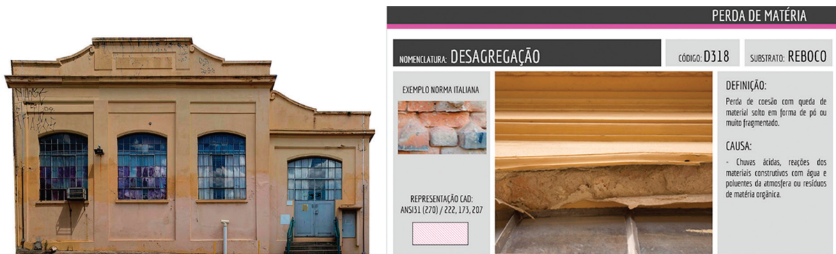
FIGURA 10 — Restituição fotogramétrica da fachada leste; imagem sem deformação da perspectiva, para avaliar conservação global. Ficha de classificação de danos para reboco elaborada no curso com base nas normativas italianas que definem classificação das patologias de materiais pétreos “naturais” e artificiais: UNI 1182:2006.
